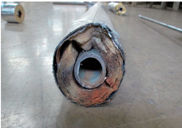
図3 撤去した給水管の断面
