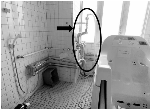
図2 蛇口に気付かれず溜まり水となっていた配管
