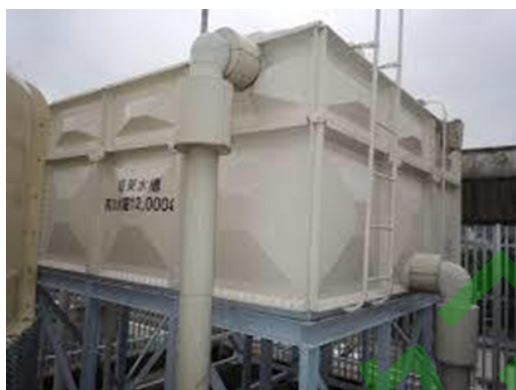
写真 5 受水槽の例（2011 岩手県）
