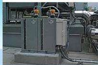
冷却水設備の維持管理
